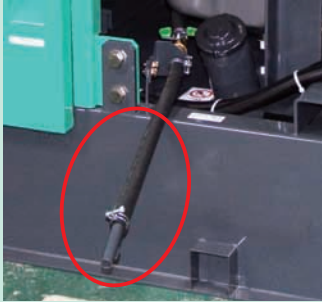
▲オイルドレンホース
